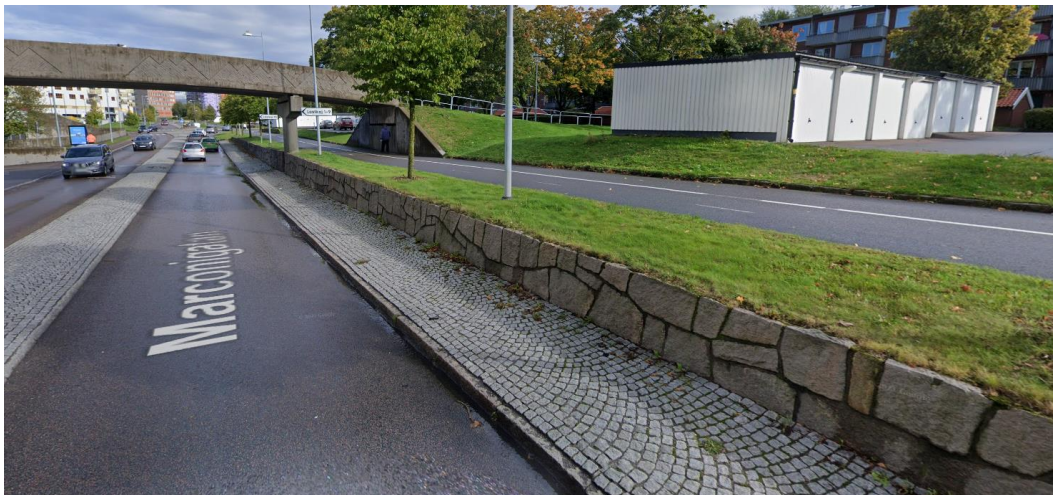
Figur 3. Stödmur mellan körbana och gång- och cykelbana vilken innebär en tillgänglighetsbegränsning. Norr är framåt i bilden. Bild: Google maps (2021).
